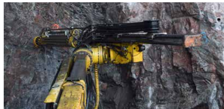
Längst fram på varje bom hänger COP 3038 hydraulisk bergbormaskiner och på två av dessa med kassett för åtta borrhåtar.
