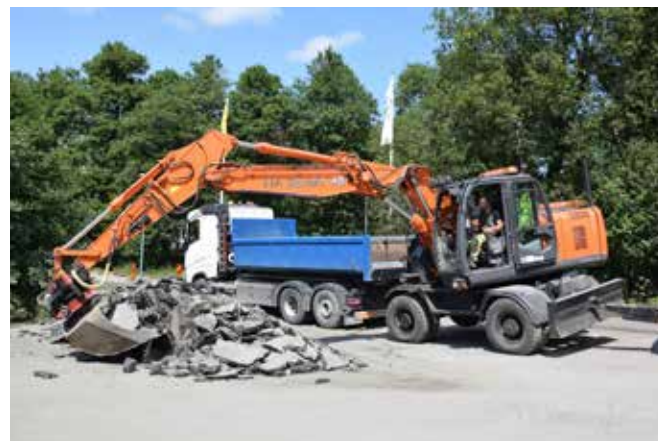
Vid etableringen utanför Landvetter finns Martin "M6" Johansson med NA Schakts Hitachi 170W-3 hjulare. Han rensar bort asfaltkakor inför en omledningsväg och lägger på Sevis lastbil.
