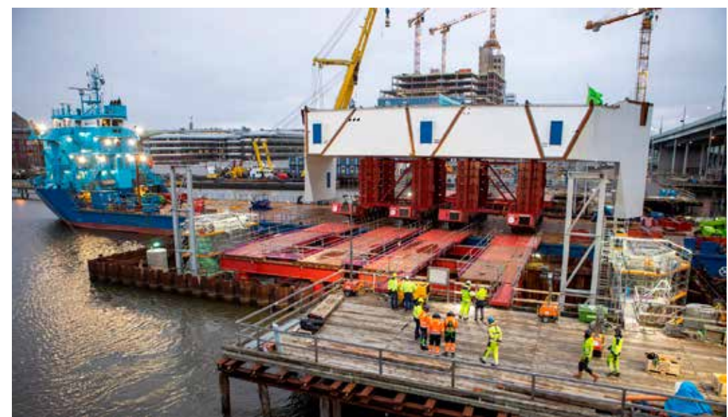
De mest omfattande momenten var när den stora stålkonstruktionerna närmast brons öppningsbara del kördes över från fartyget till brostödsfundamenten med Multiwheelers.
