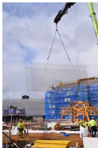
Martin ser till att armeringsmattorna hamnar på rätt plats inför gjutningarna för det nya köpcentrumet på Selma Lagerlöfs Torg.
