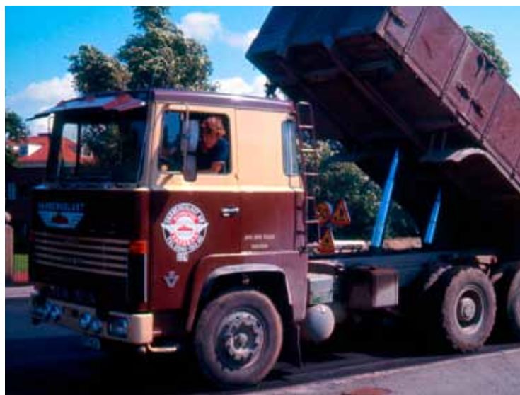
Leif Johansson från Källsjö lägger asfalt på Träslösvägen i Varberg 1972 med sin Scania LBS140 ansluten till Varbergslast. Foto: Lennart Hellin.
