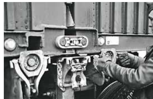
Här fästs hjulsatsen under två sammankopplade containerenheter. Slutligen drogs elkablar och luftslangar under containern och kopplades i hjulsatserna.
